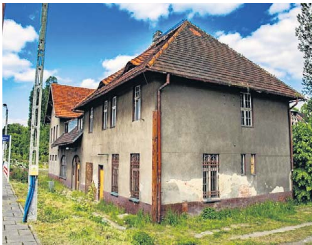
Na remont czeka także budynek zabytkowego dworca przy stacji kolejowej w Knurówie
