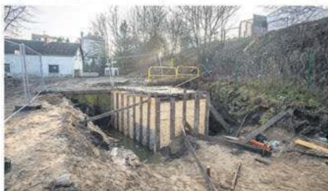
Komora wlotowa poniżej Urzędu Skarbowego łącząca dwa kolektory z miasta z kolektorem zakrywającym Strugę Jarcewską
