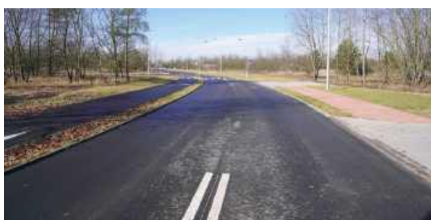
Nowa droga kosztowała nieco ponad 5 mln zł. Miastu udało się zrealizować inwestycję dzięki dotacji z Programu Inwestycji Strategicznych „Polski Ład”
