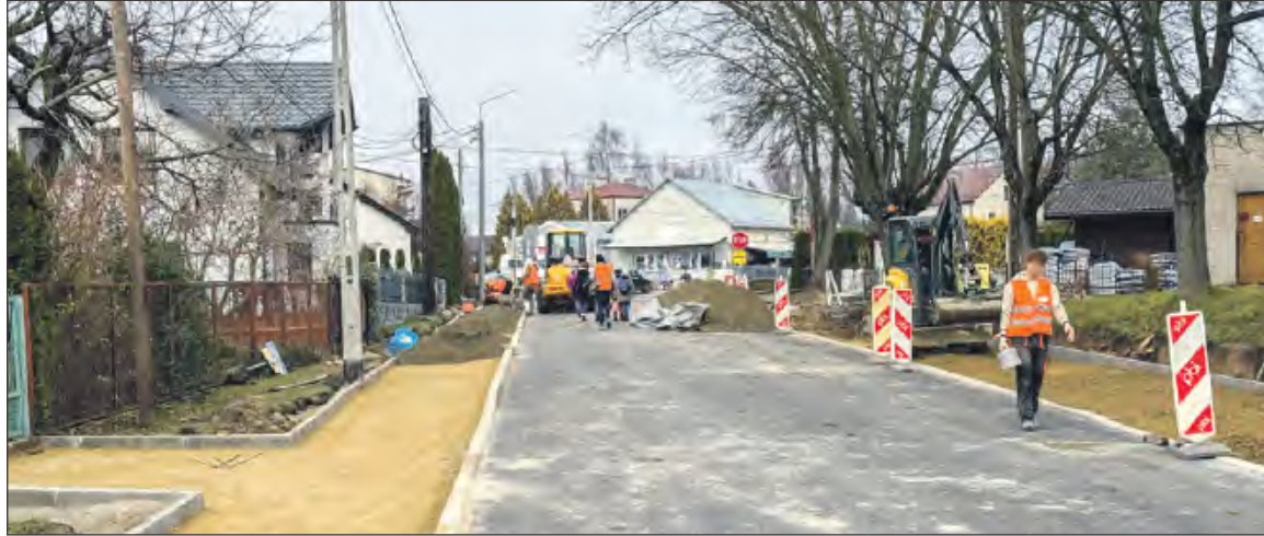
Remont drogi ruszył w połowie listopada. Mieszkańcy czekają na nową nawierzchnię, ale teraz wielu rodziców martwi się o bezpieczeństwo swoich pociec
