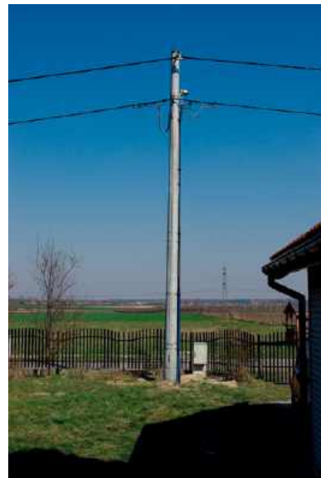
⚠ To zły stan sieci i przeciążenie wielu linii jest często przyczyną problemów. Poprawa sytuacji wymaga niestety poważnych inwestycji w infrastrukturę w całym kraju. J. ANTKIEWICZ
