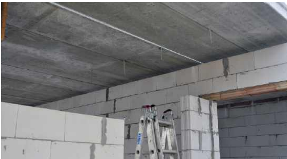
Stropy panelowe nie są narażone na klawiszowanie, na suficie nie powstają pęknięcia. STROPY.PL
