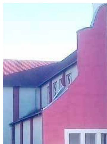
W kościele pw. św. Rafała Kalinowskiego również uszkodzeniu uległy części elewacji
