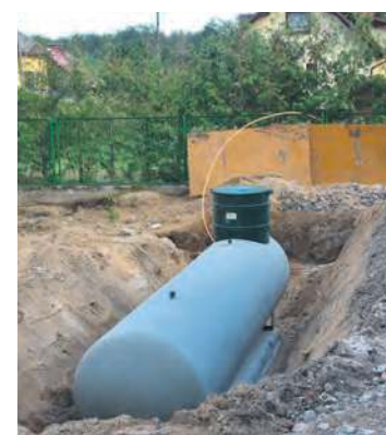
W ziemi znajduje się taki zbiornik na gaz.
