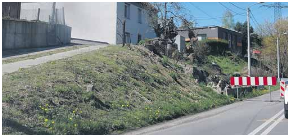
Mur osunął się w ubiegłym roku
