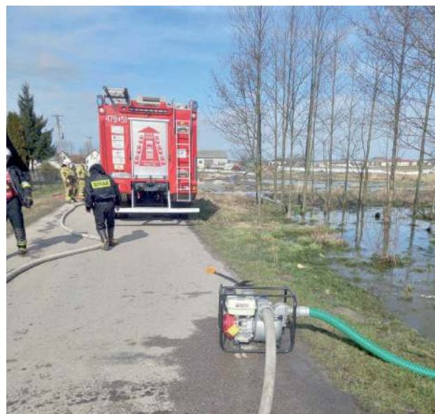
Działania strażaków polegały na wypompowywaniu wody za pomocą pompy szlamowej do wody brudnej
