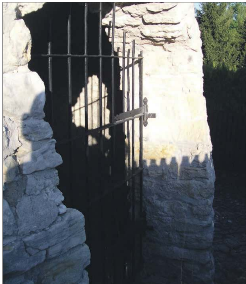
Wejście do pieców ceramicznych zabezpieczone kratą
