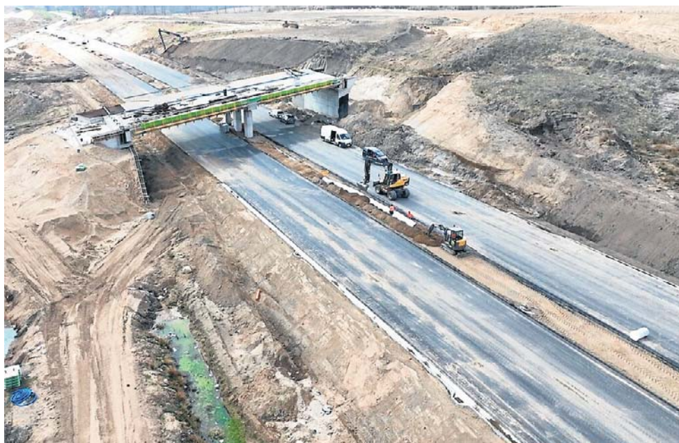
Prace przy budowie drogi ekspresowej S11 Bobolice - Szczecinek na zdjęciach z lotu ptaka.
