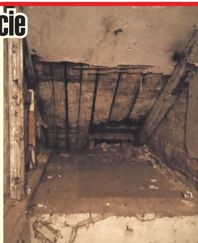
Stan techniczny schodów budzi niepokój mieszkanki
