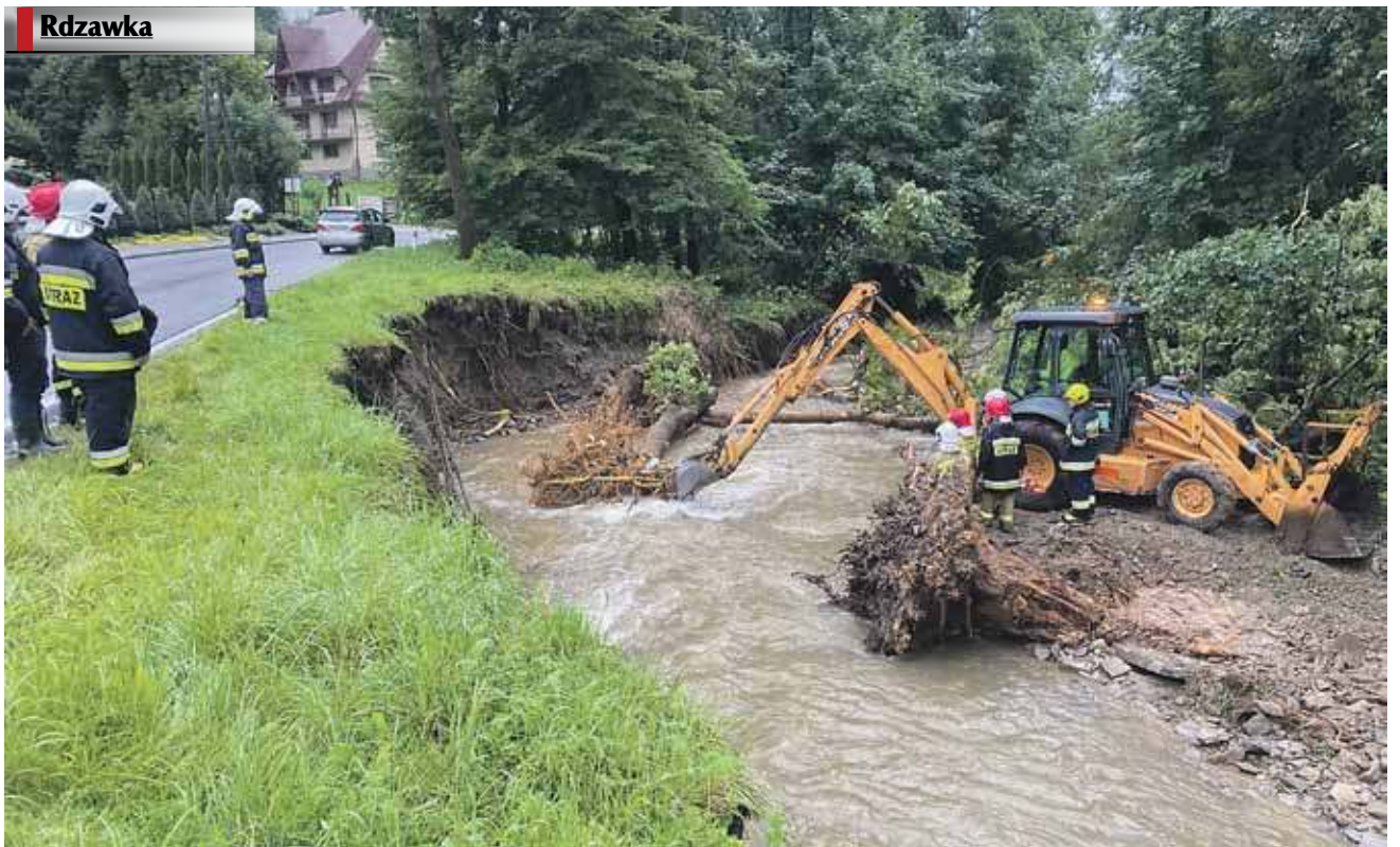
Sierpniowa powódź poważnie uszkodziła drogę w Rdzawce.
