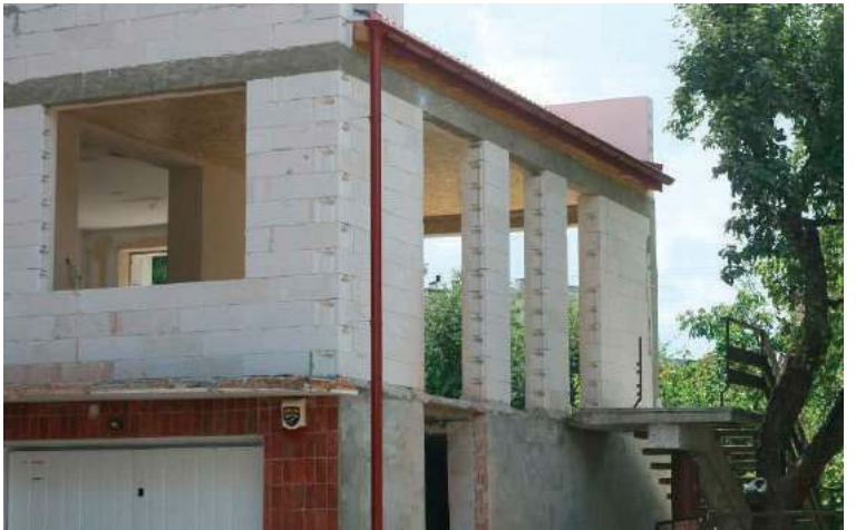
Nadbudowując garaż radny Gustaw Dmowski o 1,8 metra naruszył obowiązującą linię zabudowy
