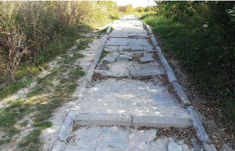
Ratusz deklaruje naprawę zrujnowanego przejścia prowadzącego do uczelnianych obiektów
