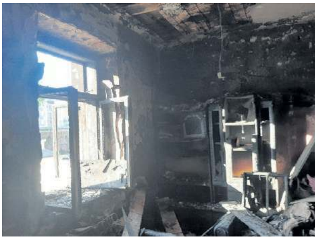
Mieszkanie na pierwszym piętrze bloku przy ul. Zamojskiej spłonęło niemal doszczętnie. Łączne straty oszacowano na 70 tys. zł. Fot. mł. bryg. Marcin Lipiec
