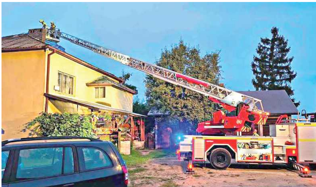
Strażacy przez wiele godzin zabezpieczali uszkodzone budynki, usuwali konary z jezdni i przywracali bezpieczeństwo mieszkańcom
