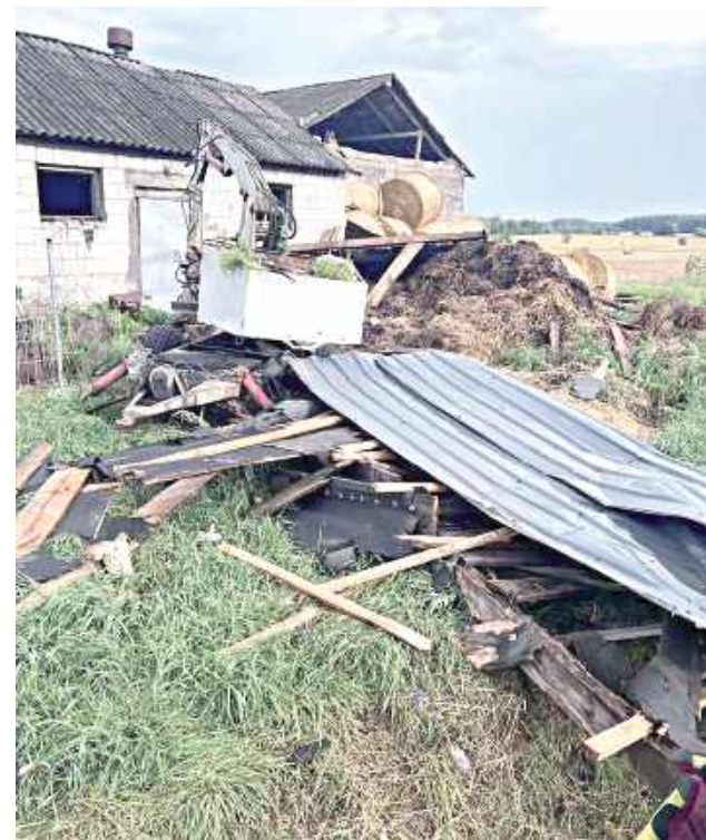
Najwięcej pracy strażacy mieli przy zabezpieczaniu budynków uszkodzonych przez silne podmuchy wiatru
