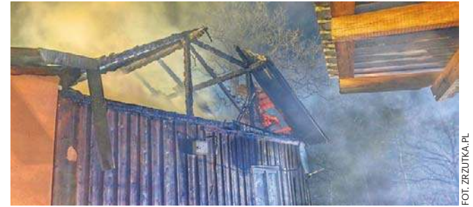
Ogień zniszczył część konstrukcji domu oraz instalacje
