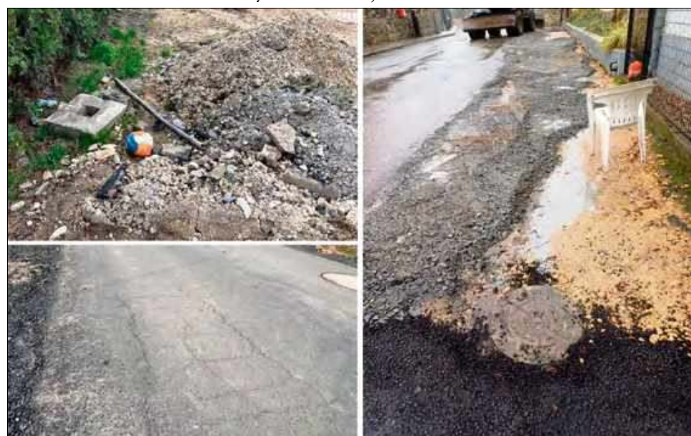
-Sam osobiście widziałem jak asfalt był kładziony w deszczowy dzień – mówił na spotkaniu mieszkaniec Jasionej, który zwracał również uwagę na inne mankamenty.
