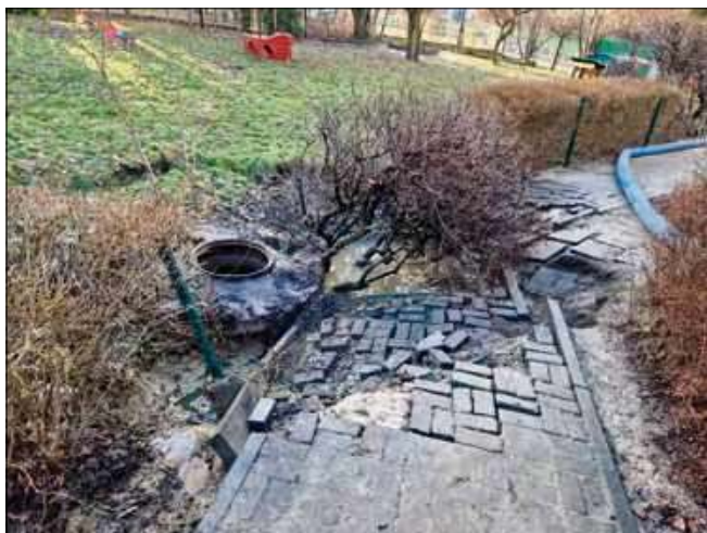
Podczas prac przy awarii kanalizacji w rejonie przedszkola przy ul. Zielonej w Zdzieszowicach okazało się, że w kanalizacji jest bardzo dużo śmieci.
