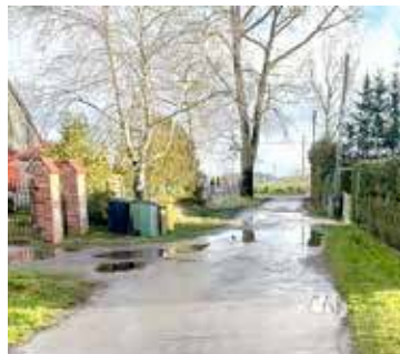
Droga miejscami jest mocno pniszczona, przez co ciężko jest tędy w ogóle przejść
