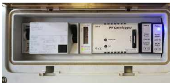
Rysunek 1. Gotowy rejestrator energii z licznikiem i zasilaczami, zainstalowane w małej plastikowej skrzynce rozdzielczej
