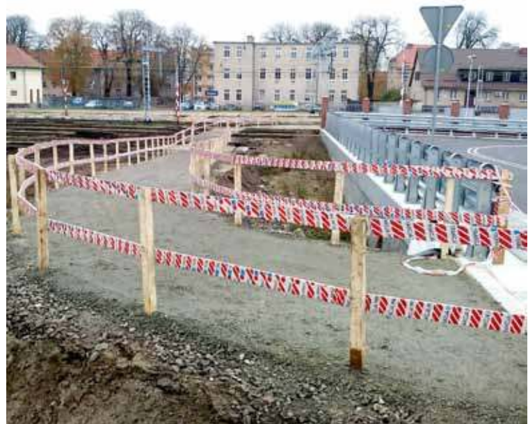
Przejście w poziomie szyn do Zintegrowanego Centrum Przesiadkowego nie zostało odebrane przez nadzór budowlany.
