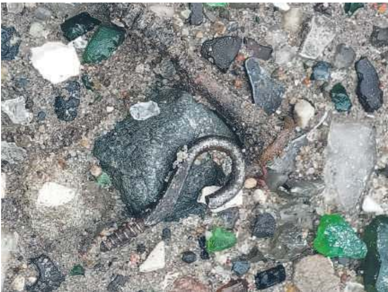
Przy ostatnim utwardzaniu drogi wraz gruzem trafiły na nią śruby i druty
