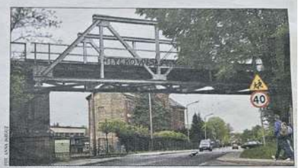
Zdaniem właściciela wiaduktu, jego stan techniczny jest zły się do jego rozbiórki. Prace chcieli - tego postawili warunki, między
