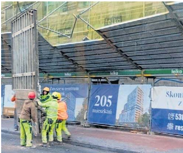
Spadająca z góry płyta uszkodziła rusztowanie i zabezpieczenie nad chodnikiem
