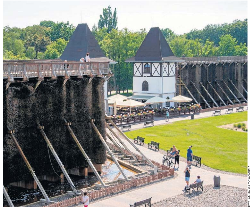
Tężnie będą nieczynne przez około 9 miesięcy. Wymagają poważnego remontu
