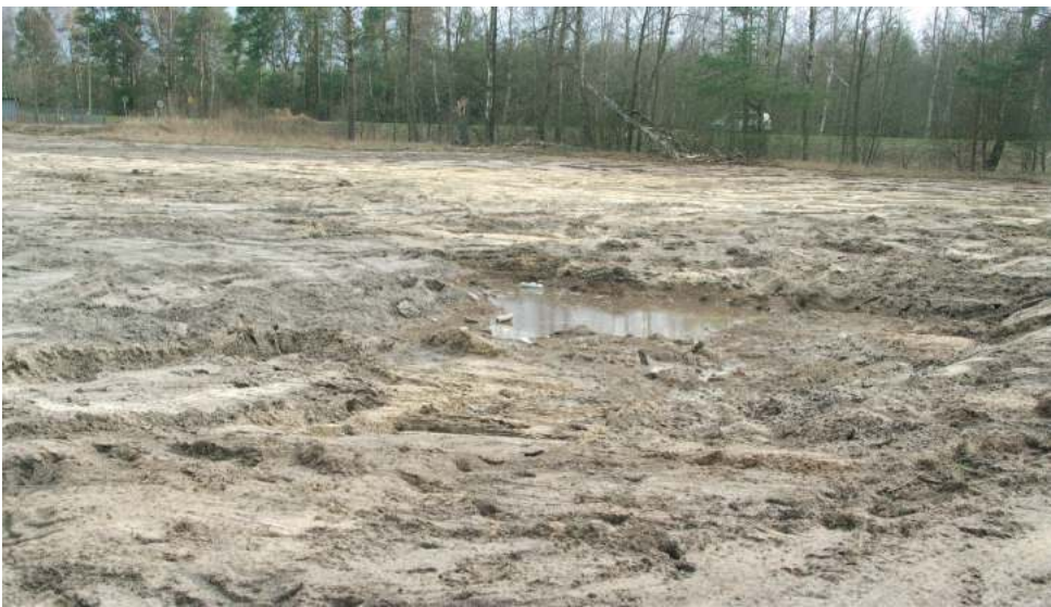
W ubiegłym tygodniu częściowo zasypano dziurę na działce gminnej w Sosnowicy
