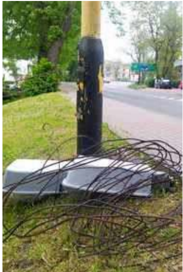
Stare oprawy oświetleniowe składowane przy samych słupach jeszcze z lat 70-tych i 80-tych
