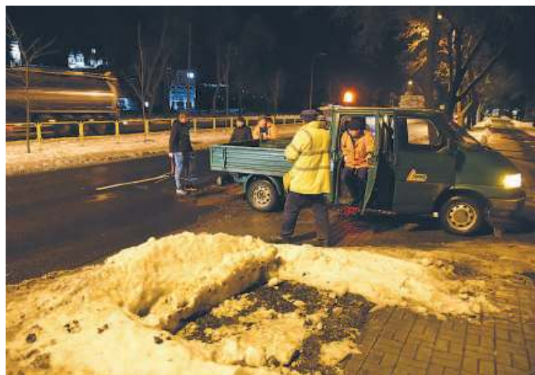
Drogowcy wsypali żużel do wyrwy, ale problemu nie rozwiązali
