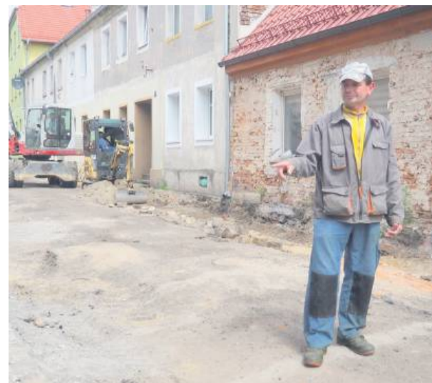
– Przy mojej posesji nie ma odprowadzenia wody deszczowej. Myślałem, że podczas remontu projektant to uwzględni – mówi Waldemar Rataj
