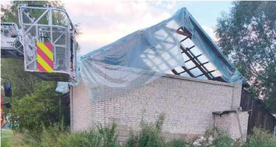
Strażacy zabezpieczyli budynek, z którego został zerwany dach
