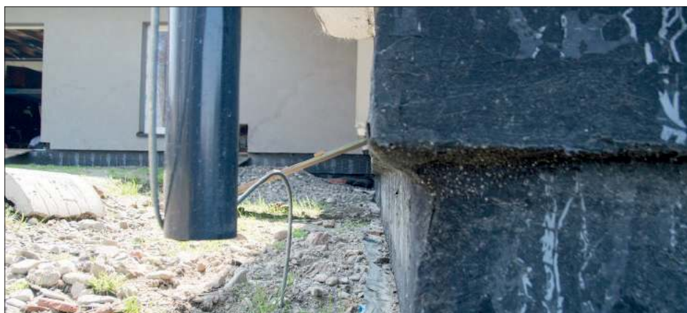
■ Jeden z poważniejszych błędów, czyli przesunięcie konstrukcji budynku względem podstawy. To sprawia, że śruby mocujące znajdują się zbyt blisko krawędzi, co z kolei może rodzić niebezpieczeństwo uszkodzenia domu podczas silnego wiatru. – To tylko przykład. Wiele prac wykonano inaczej niż w projekcie. Zachodzą rozbieżności w wymiarach elementów konstrukcyjnych, a niektórych wręcz brakuje – wylicza Grabowski.
