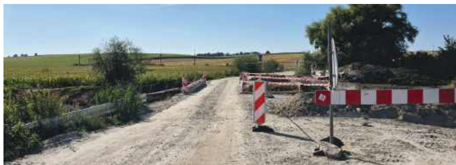
W środę, 9 września, doszło do awaryjnego zamknięcia remontowanego w Białym Kościele mostu. Fot. PZD
