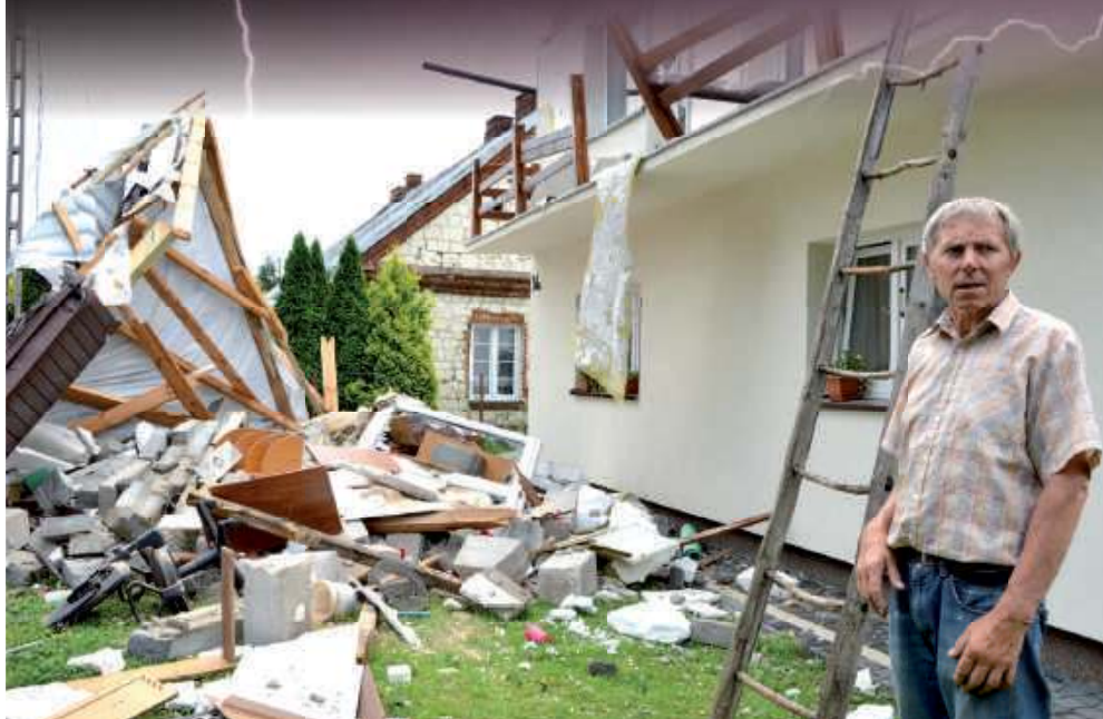
KOLONIA SZCZĘKARKÓW - Niedawno człowiek otrzęsął się po powodzi, a tu teraz jeszcze gorsze przyszło. Bo wtedy to dach nieuszkodzony był. Woda zesłała. Wszystko się posprzątało, a teraz w nocy jeszcze lało. Zalało stropy. Woda przesiąkała na dół. Podłogi już „popuchły” – mówi pan Henryk Giza, któremu wichura zerwała dach z domu
