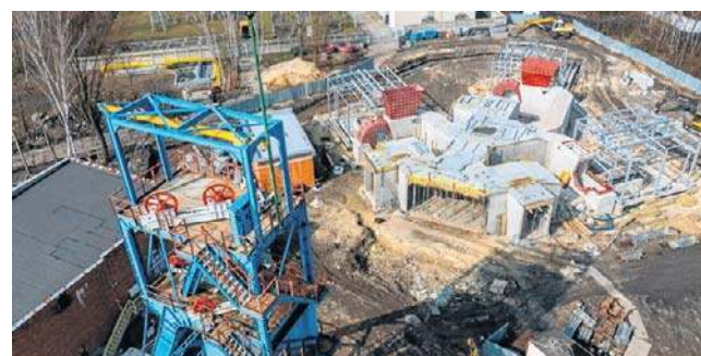
Ucierpieli pracownicy Przedsiębiorstwa Budowy Szybów
