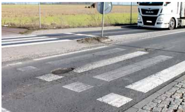
Ubytki, jak widać, są dość głębokie
