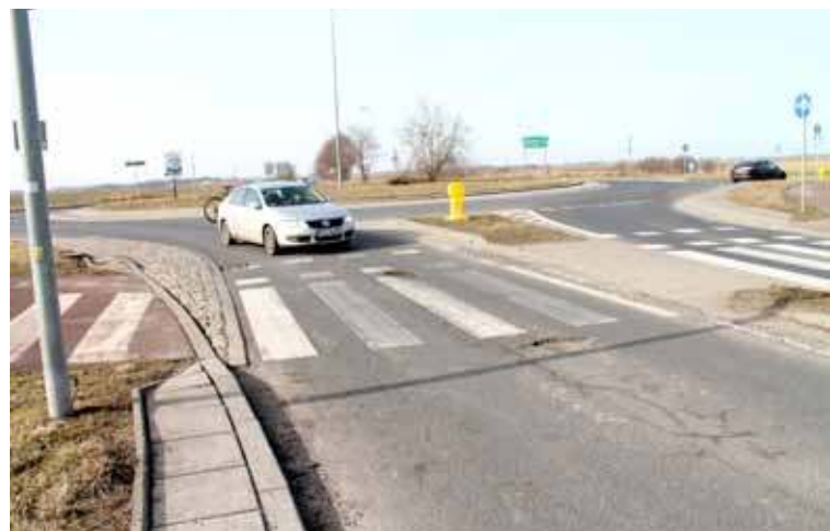
Dwie dziury na przejściu powodują, że kierowcy po zjechaniu z ronda muszą szczególnie uważać, by nie wpaść w nie kołami
