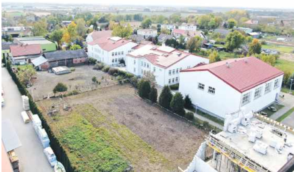
Zamontowane panele fotowoltaiczne na budynku Szkoły Podstawowej w Krynicznie
