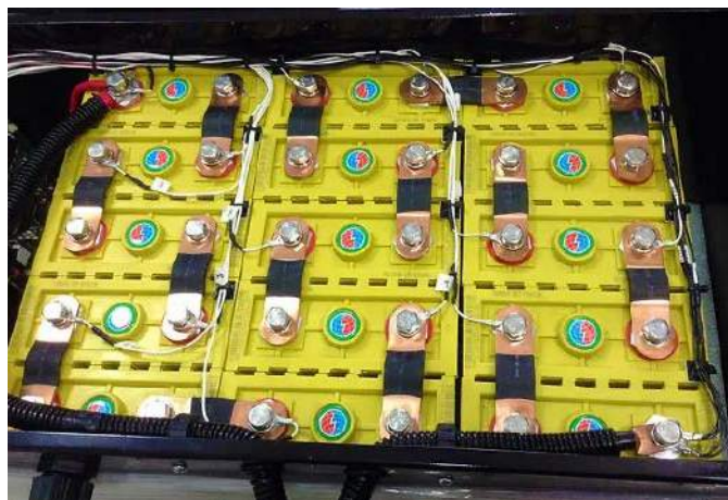
Fotografia 10. Pakiet akumulatorów współpracujący ze scentralizowanym systemem BMS (t.ly/xrWXg)
