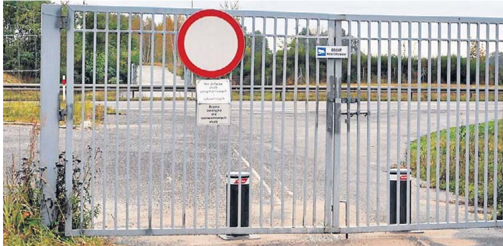
Przy A18 służby odnotowują regularne przypadki niszczenia zabezpieczeń bram awaryjnych
