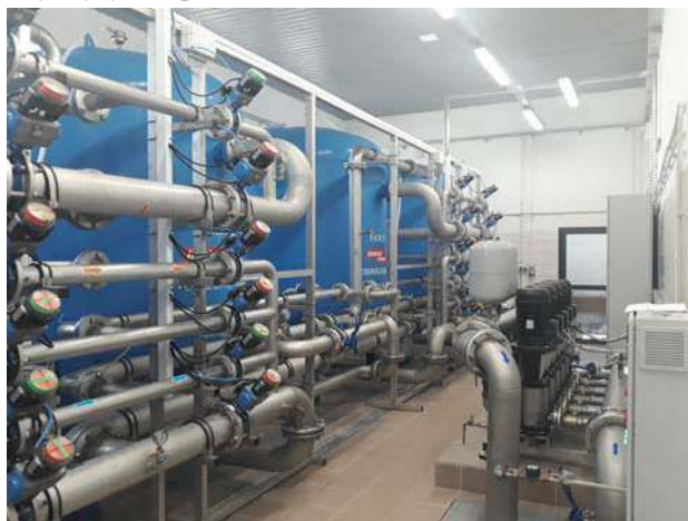
Stacja uzdatniania wody w Nowej Różance
