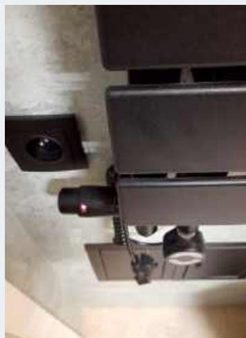
🔧 Do każdej drabinki dodano głowicę termostatyczną i grzałkę elektryczną.
