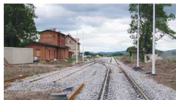
Dobiega końca budowa linii kolejowej nr 319 relacji Strzelin – Kondratowice – Łagiewniki. Na zdjęciu widoczny dworzec PKP w Kondratowicach
