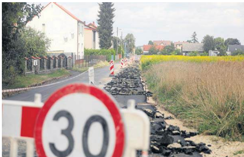
Droga przeorana przez ciągnik ma zostać naprawiona
