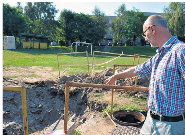
Miesiąc temu była pierwsza awaria, którą po tygodniu częściowo usunięto. Wykop pozostawiono
