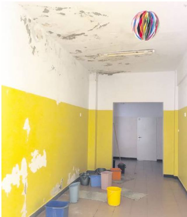
Podczas deszczu z sufitu leje się woda, a ze ścian odłazi farba.
