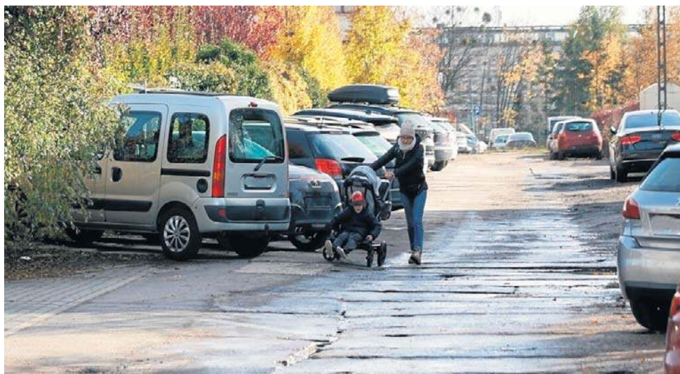
W takim stanie jest odcinek ulicy Budziszyńskiej, gdzie wybudowano domy wielorodzinne. Cała jest zatarasowana samochodami
