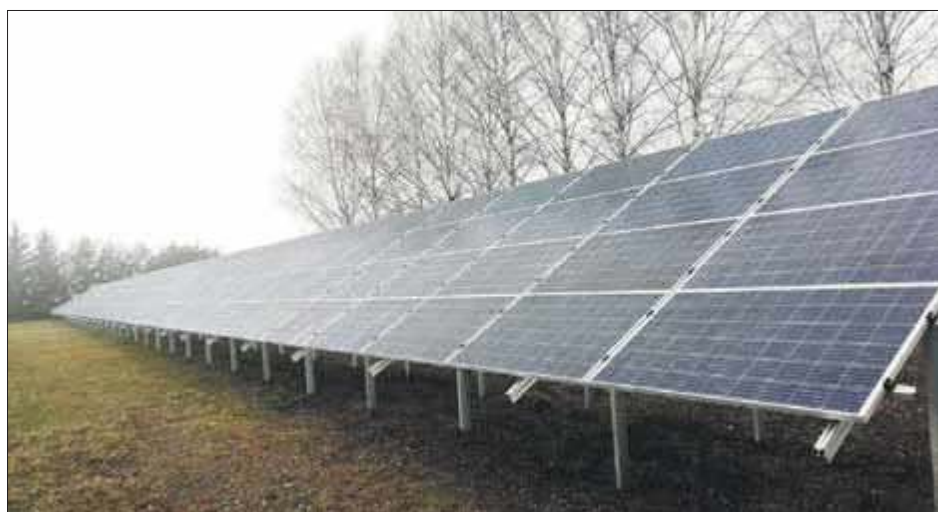
Na obydwu ujęciach wody zainstalowane zostały nowoczesne instalacje fotowoltaiczne
