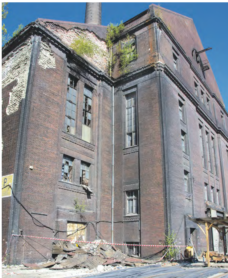
Zniszczona, uszkodzona elewacja jest systematycznie odnawiana
