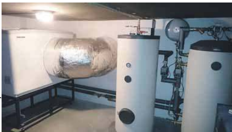
Pompa ciepła powietrze-woda w leśniczówce TPN w Dolinie Chochołowskiej.
