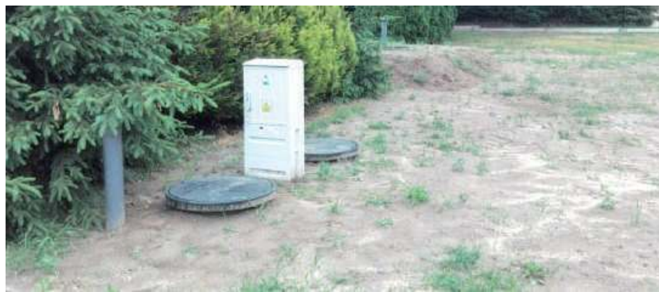
Frampol szuka chętnych na takie jak na zdjęciu, przydomowe oczyszczalnie ścieków
