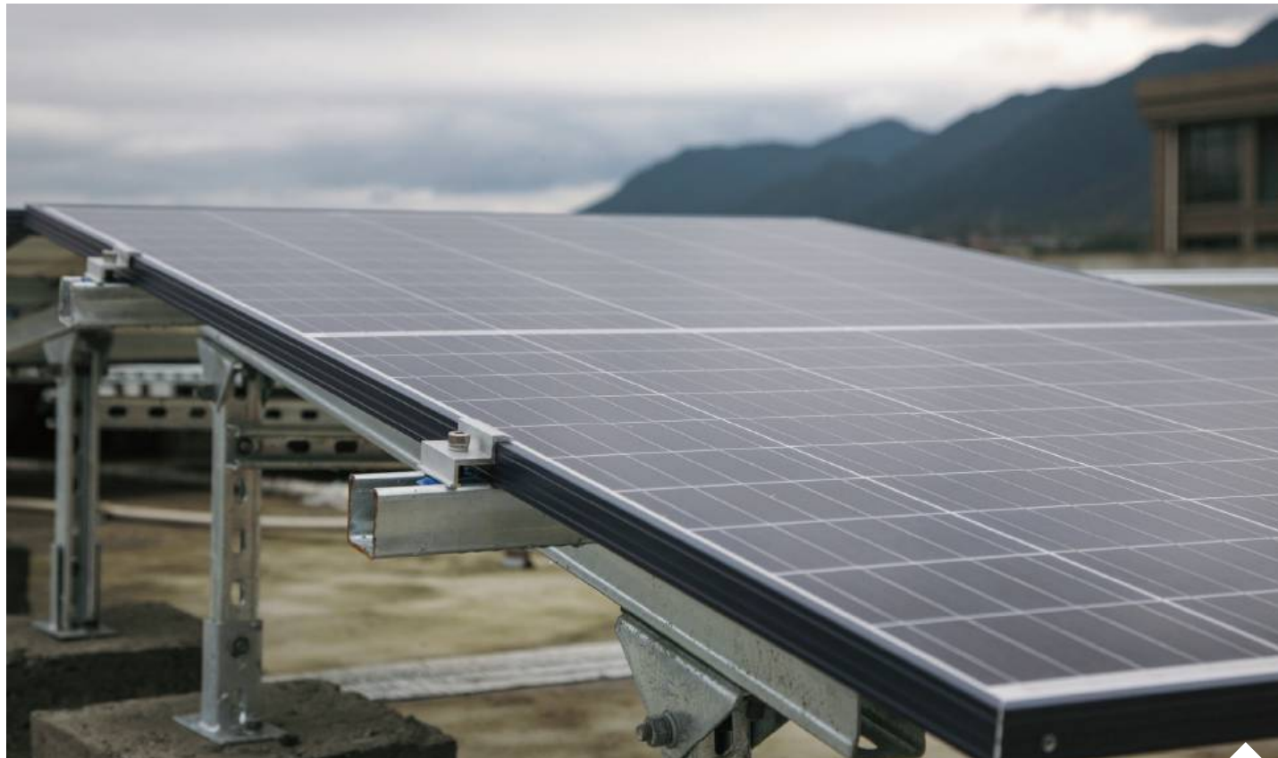
Panele fotowoltaiczne na dachach czy balkonach bloków mieszkalnych to rozwiązanie, dzięki któremu zarządcy budynków mogą obniżyć koszty ich eksploatacji | fot. Pixabay/d
