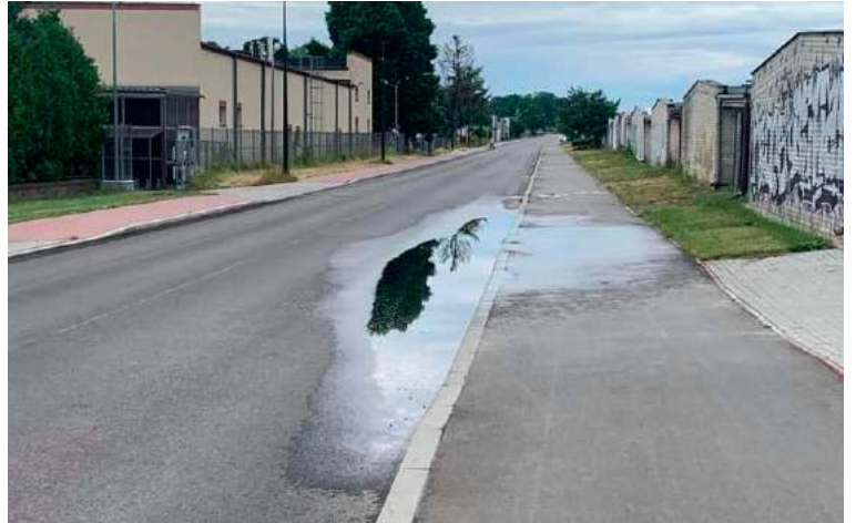
Na nowo wybudowanej ulicy Targowej już tworzą się kałuże
