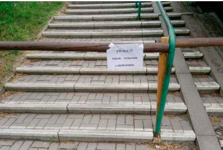
Zamknięte schody przy ul. Paganiniego
